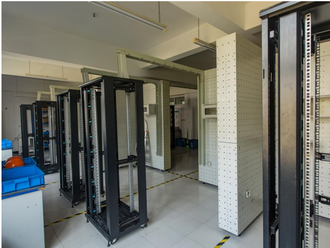
S218 综合布线实训室
