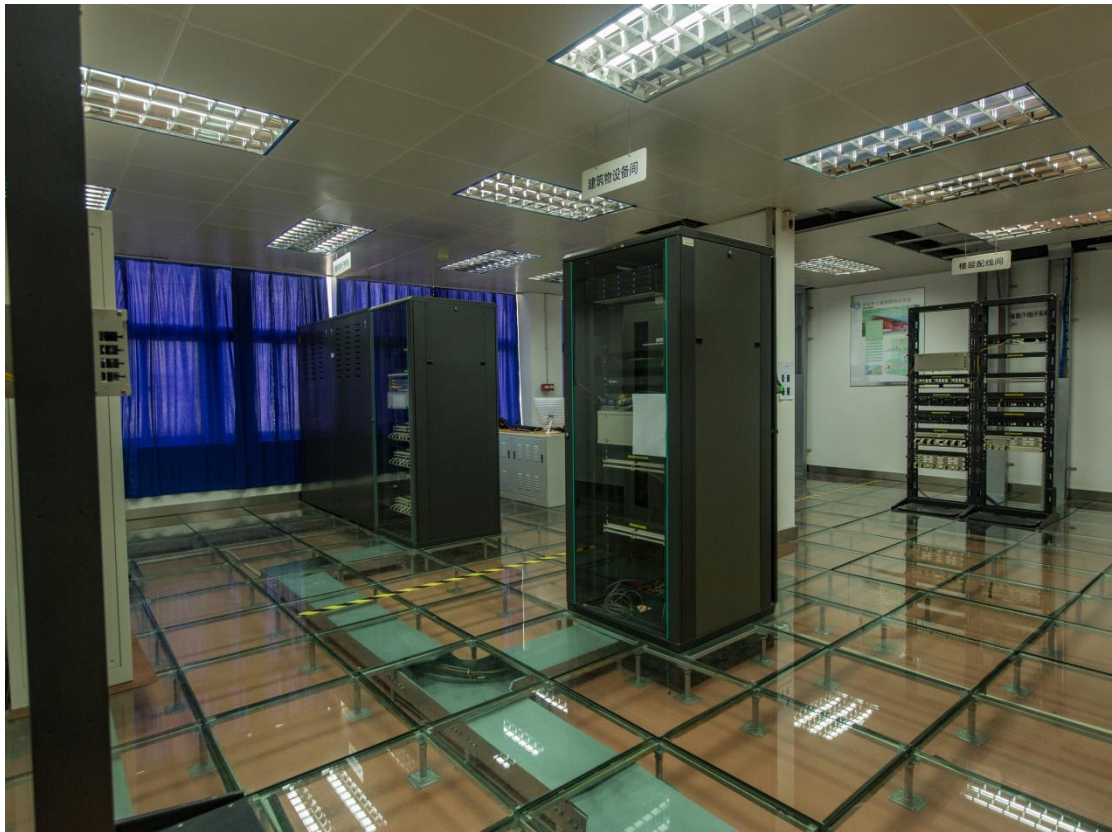
S214 通信系统网络集成实训室
