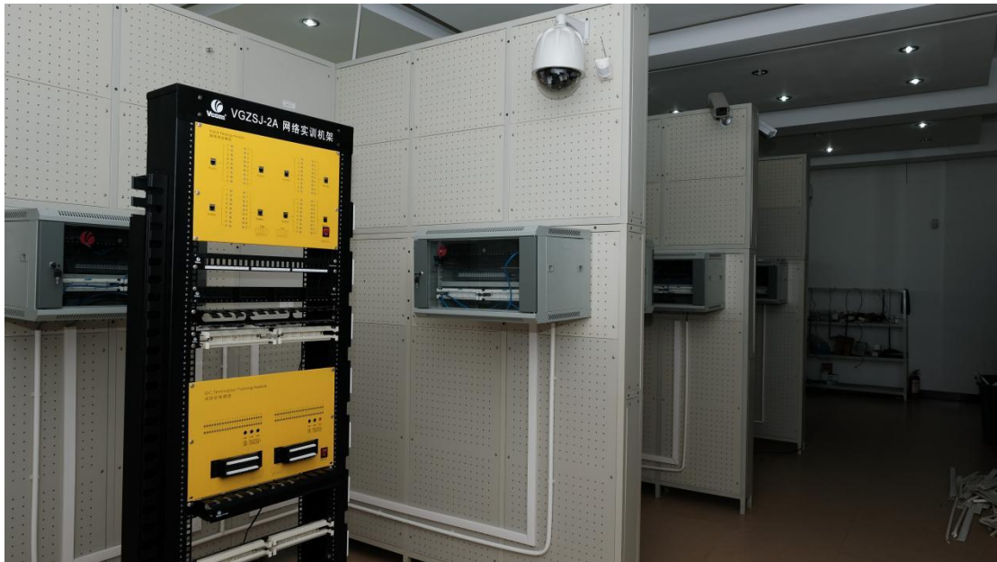
J412 综合布线实训室
