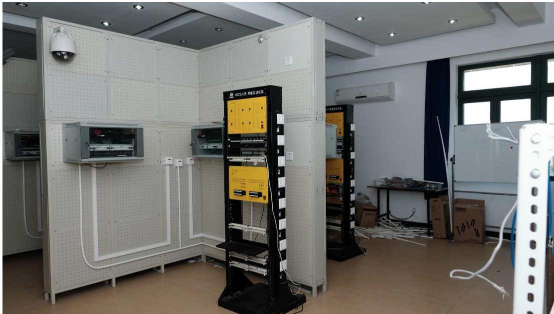
J412 综合布线实训室
