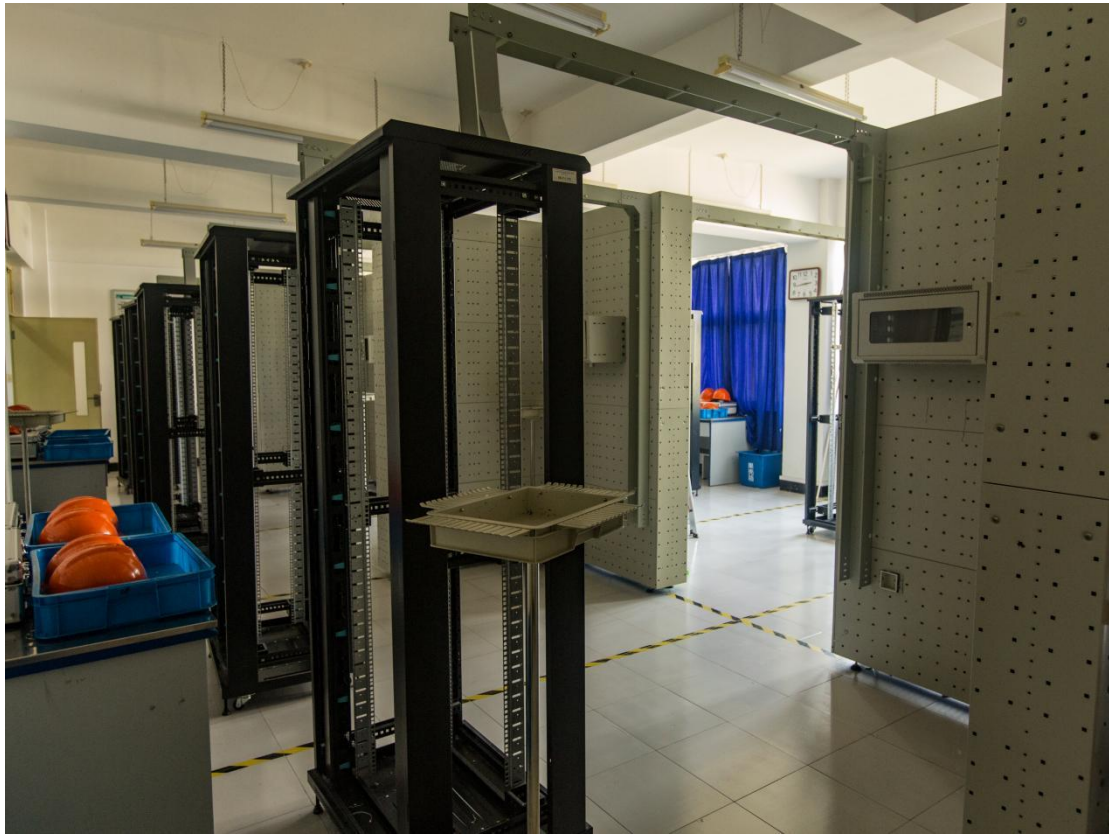
S218 综合布线实训室
