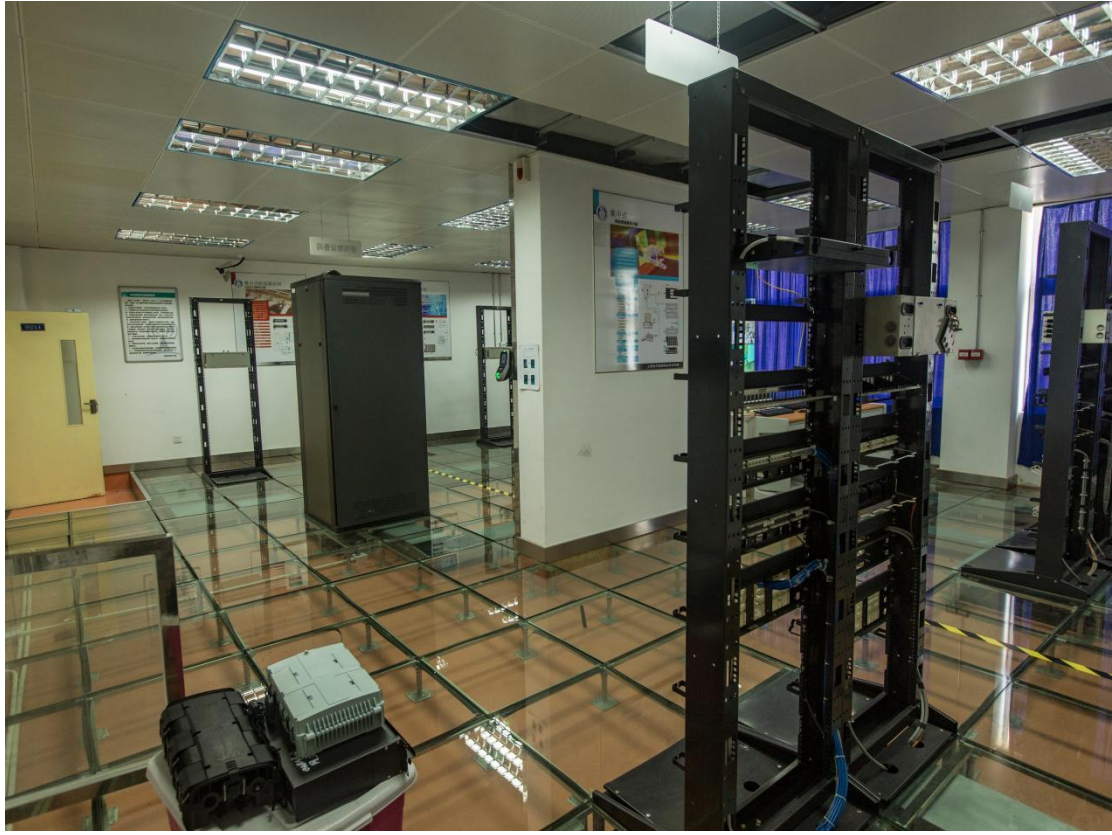
S214 通信系统网络集成实训室
