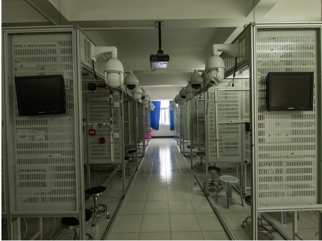
N209 楼宇通信综合实训室
