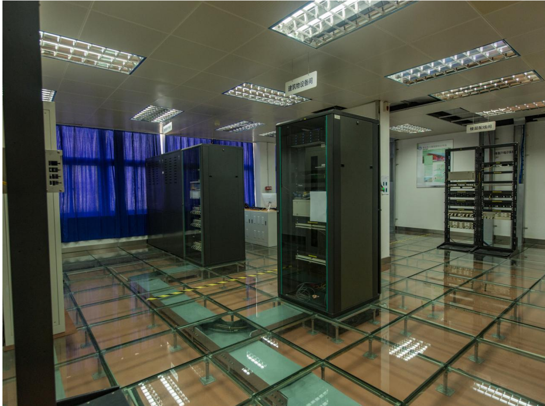
S214 通信系统网络集成实训室
