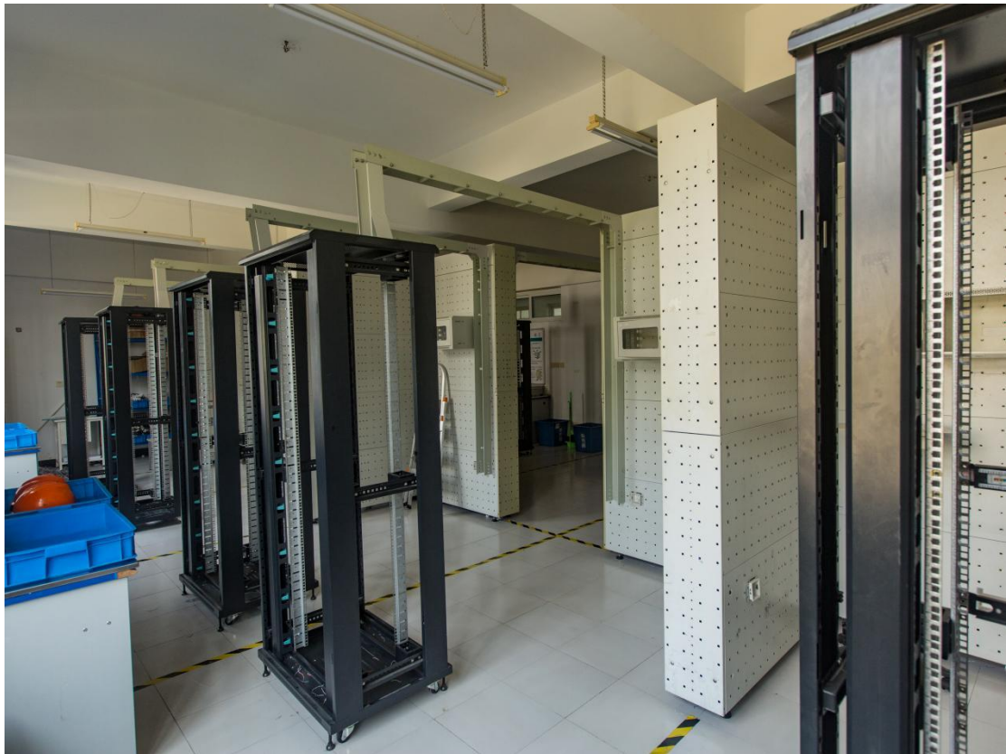
S218 综合布线实训室
