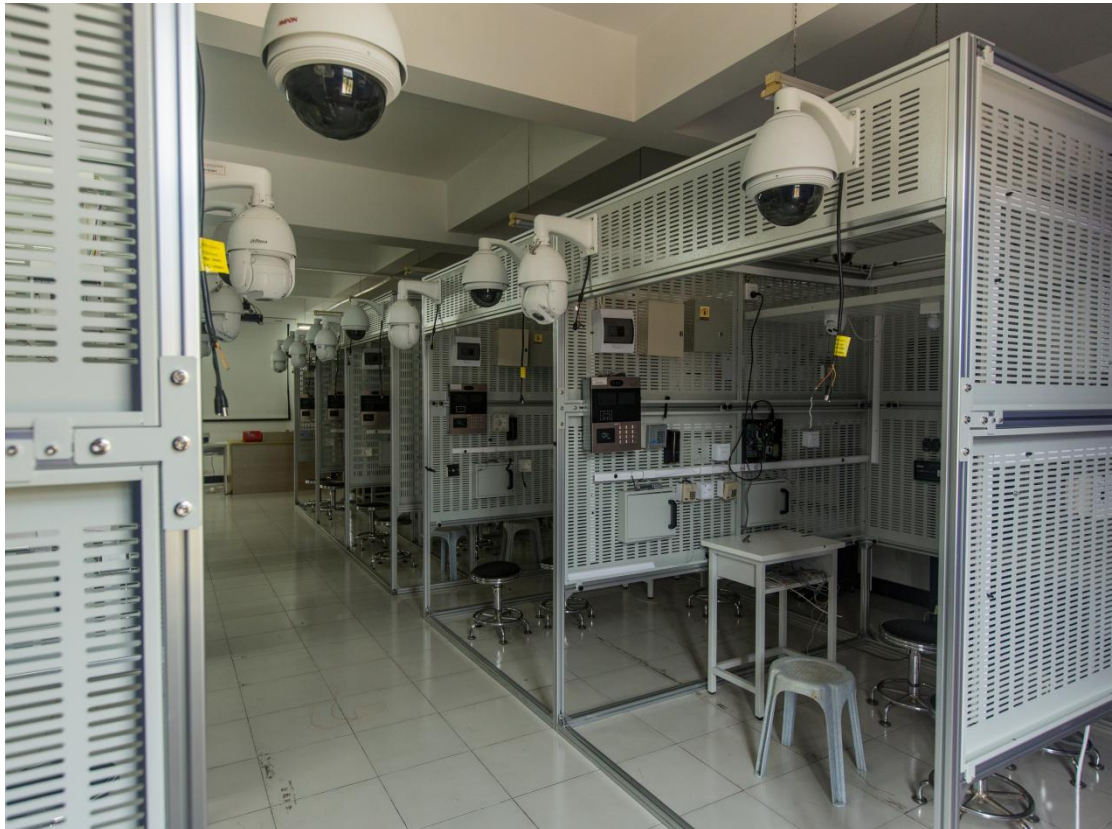
N209 楼宇通信综合实训室
